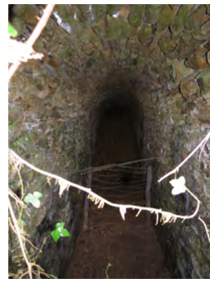
Photo 2: Ind. 135, galerie d'accès à une exploitation obstruée par un effondrement au Petit Bohneur
