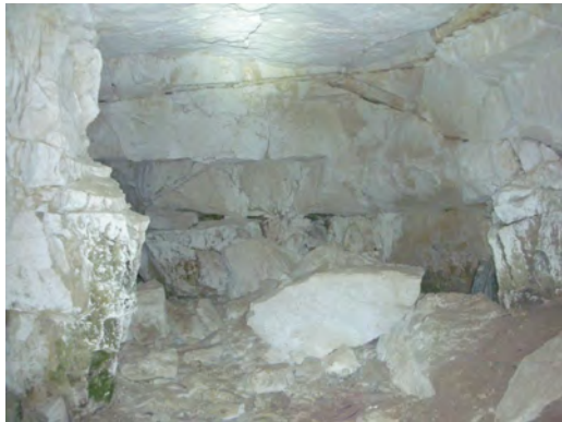
Photo 10: Chute de bloc et pilier fracturé au lieu-dit la Pinochère (Ind 024 à 027)
