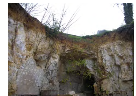
Photo 9: Effondrement de coteau au lieu-dit Le Pont des Roches (Ind. 017)
