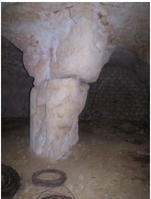
Photo 2: Pilier fragilisé, secteur de La Périchère
