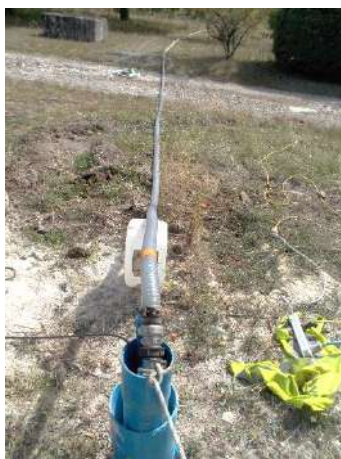
Photo 5 : ligne de pompage
