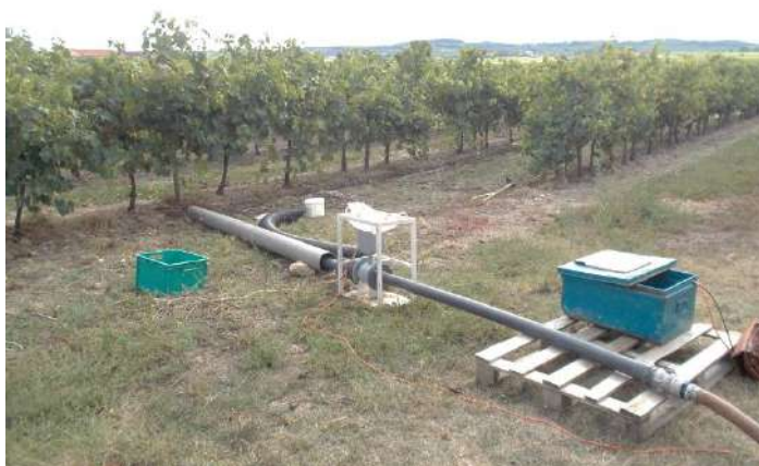
Photo 6 : ligne de débitmetrie avec vanne de contrôle de débit
