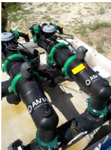
Filtres à eau puits producteur
