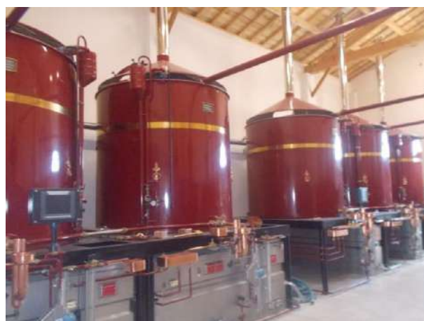
Cuves de refroidissement des alambics
