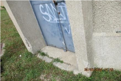
Ferrillages apparents à l'extérieur
