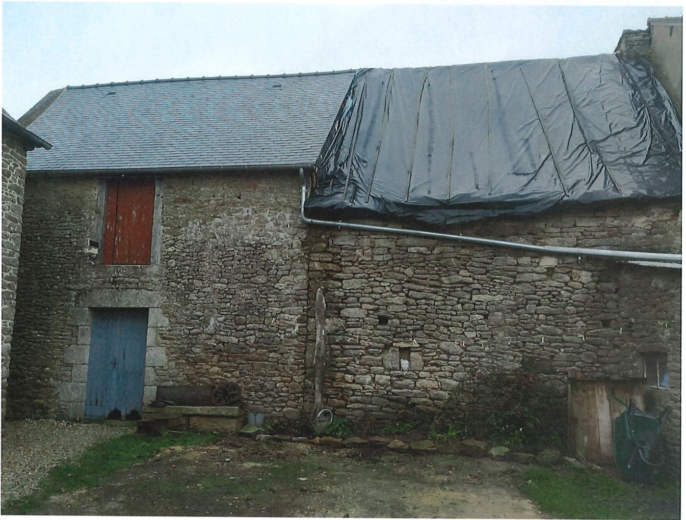
Vue arrière du bâtiment dans ma cour ( toit bachelé)
