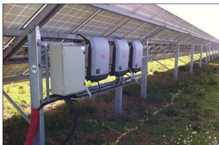
Exemple d'onduleurs strings fixés à l'arrière des tables de modules
