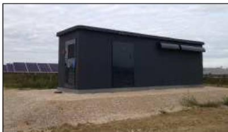
Exemple de poste électrique (livraison et transformation)
