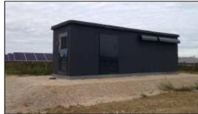
Exemple de poste électrique (livraison et transformation)
