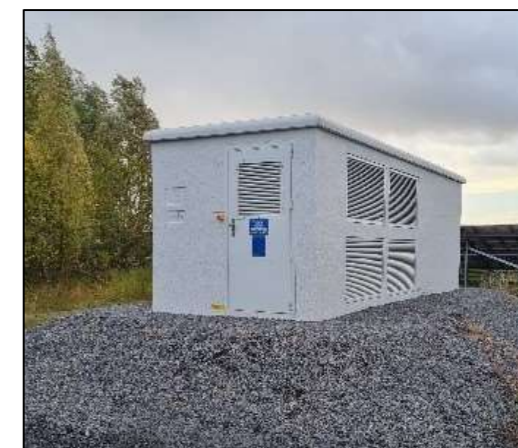
Exemple de poste de transformation
