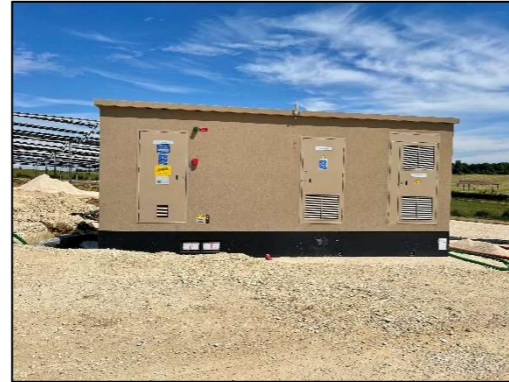
Exemple de poste de livraison
