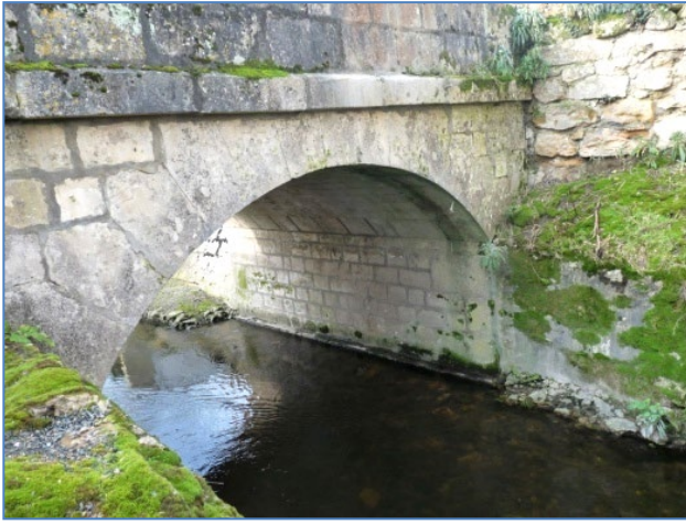
Exemple de pont ayant fait au sein de la ZEL l'objet de vérification quant à son potentiel d'accueil et à la présence éventuelle de chiroptères – A. Liger, Ecosphère
