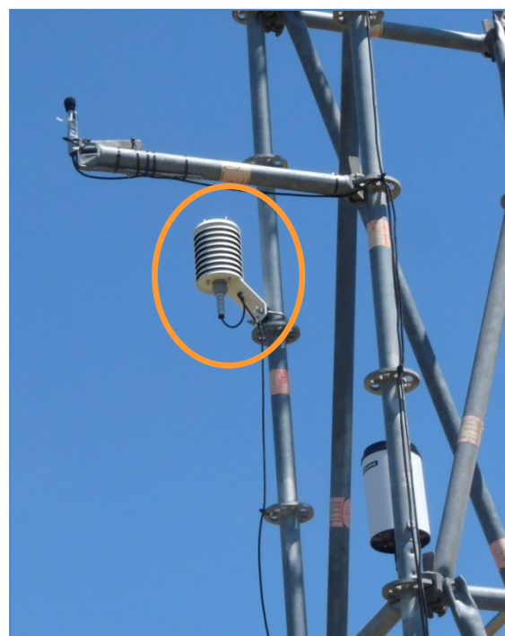
Vue sur un des capteurs météorologiques fixé sur le mât de mesures (cercle orange) – A. Liger, Ecosphère
