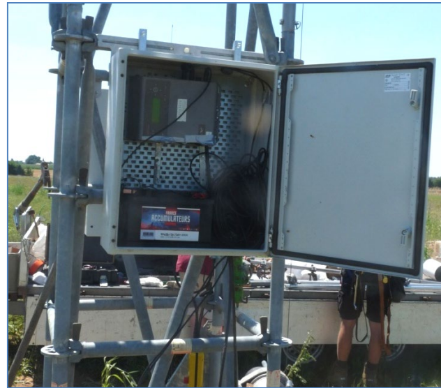
SM3BAT et batterie installés dans un caisson de protection accroché au mât de mesures – A. Liger, Ecosphère
