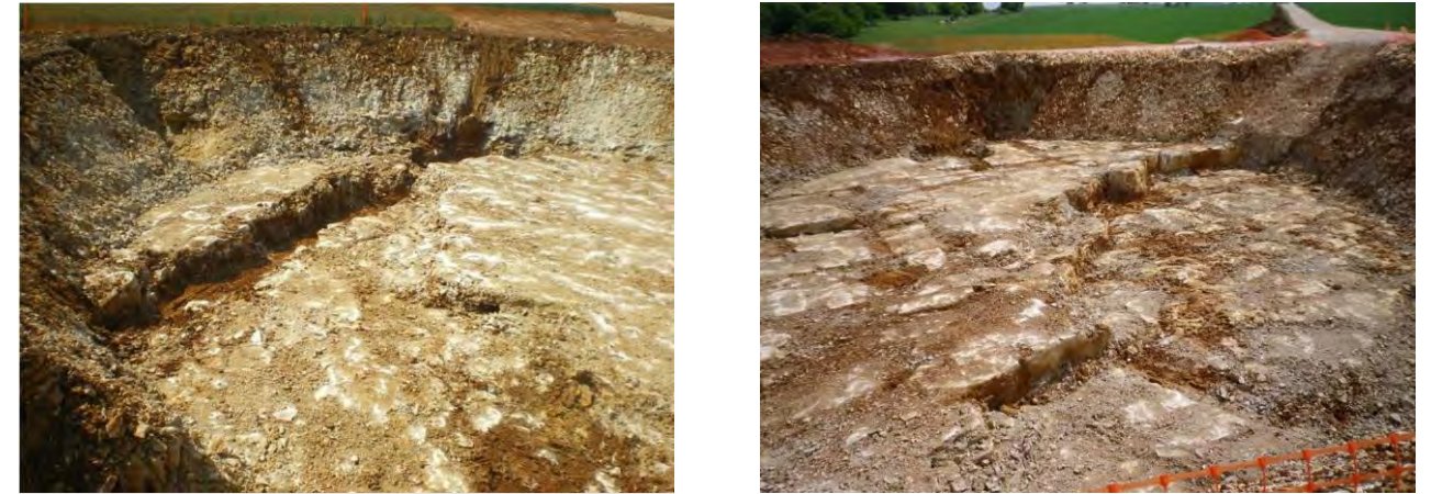
Exemples d'anomalies détectées après l'excavation qui ont nécessité une consolidation du fond de fouille avant la réalisation de la fondation superficielle
