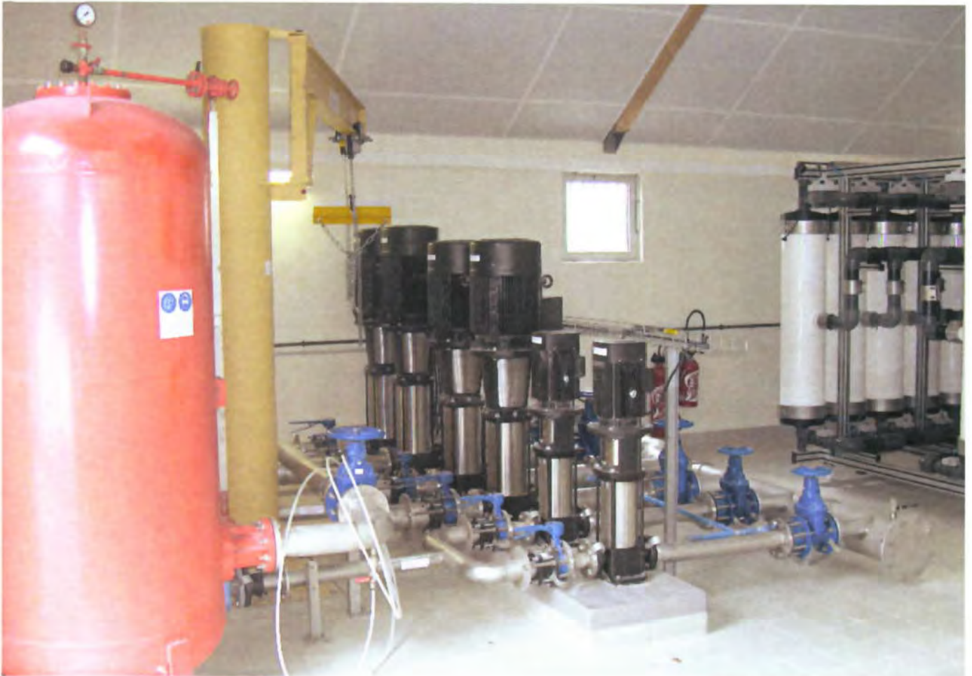
Pompage et ultrafiltration
