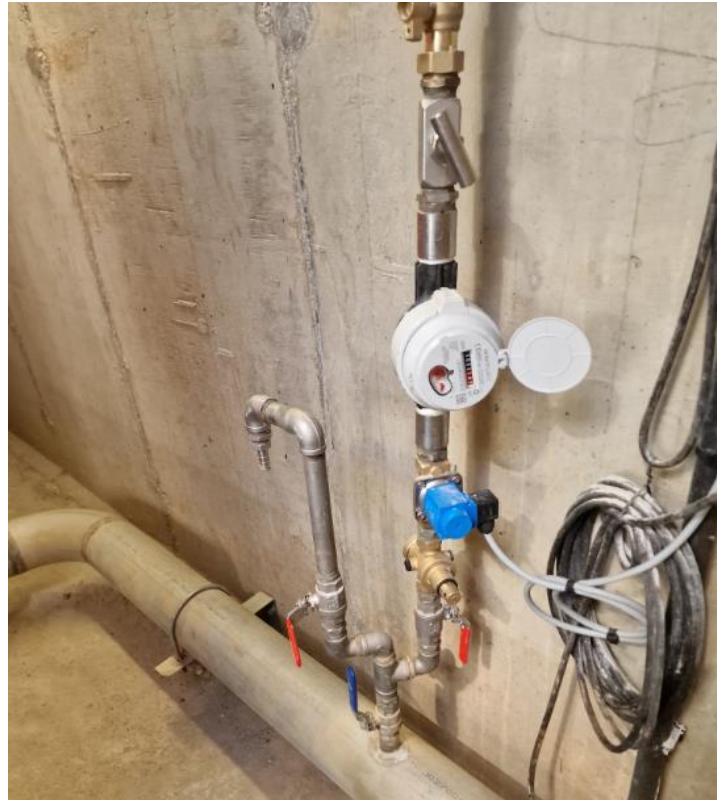
Figure 62 : Canalisation d'apport d'eaux brutes au fossé compensatoire
