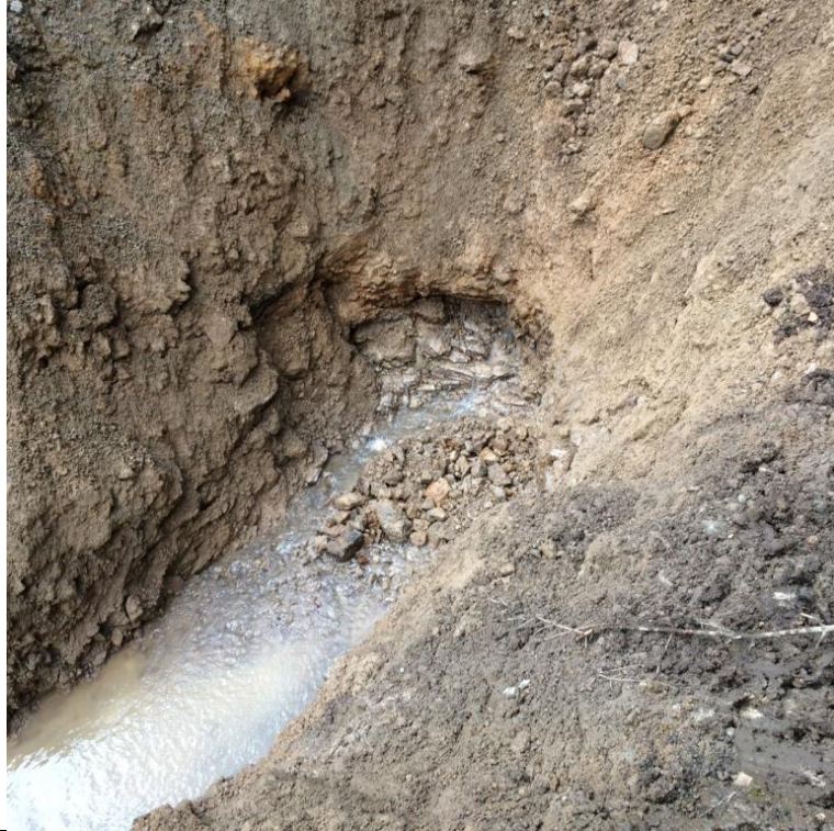
Venue d'eau dans la partie amont du terrassement
